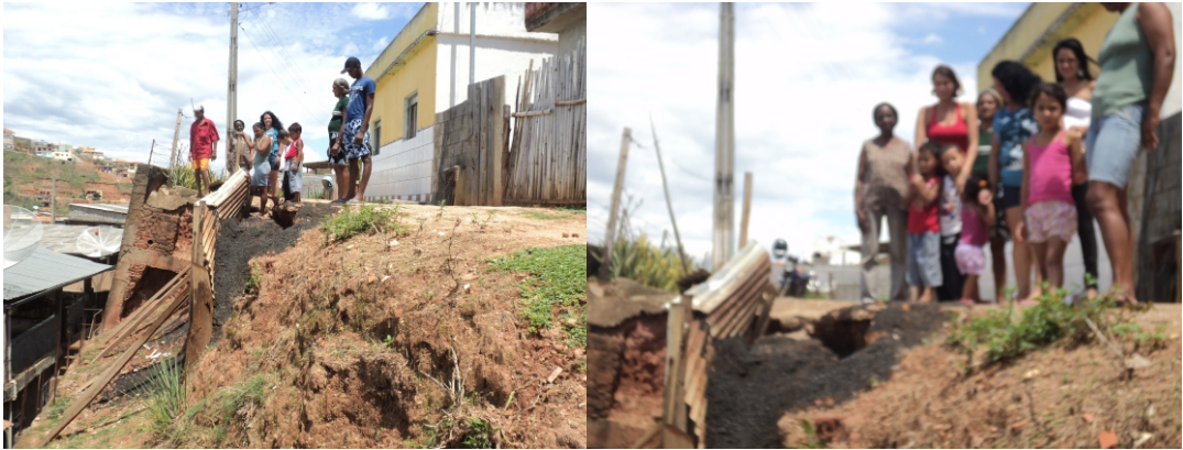
Populares observando situação do muro de arrimo que esta desabando
